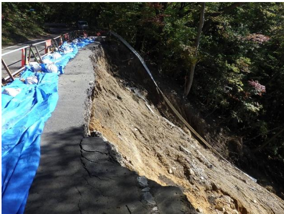
（着工前）被災状況
